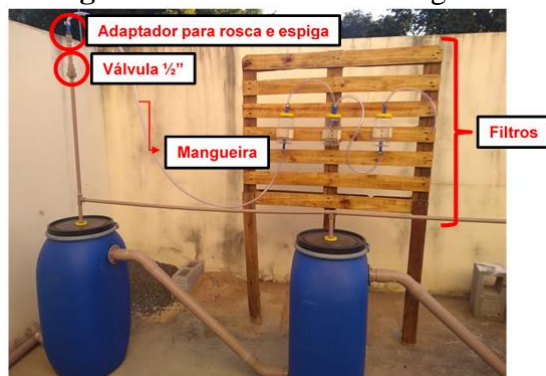
Figura 3 – Estrutura do biodigestor.
