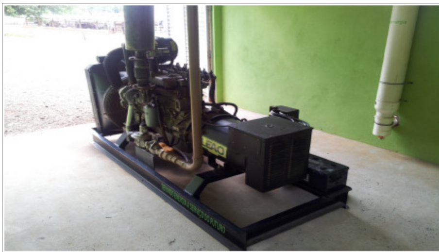
FIGURA 6 - Motor gerador UGC
